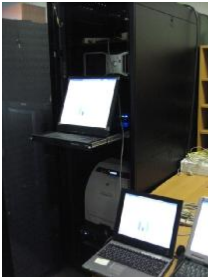
EOC SCADA Server
